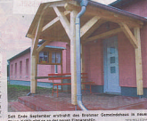
Das Foto zeigt die Türbreite, die der Bauamt kritisiert. Die Tür ist zu gering für den Ein- und Ausstieg.
